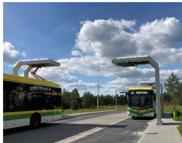
Rys. 4.8 Ładowanie autobusu elektrycznego akumulatorowego z ładowarki pantografowej
