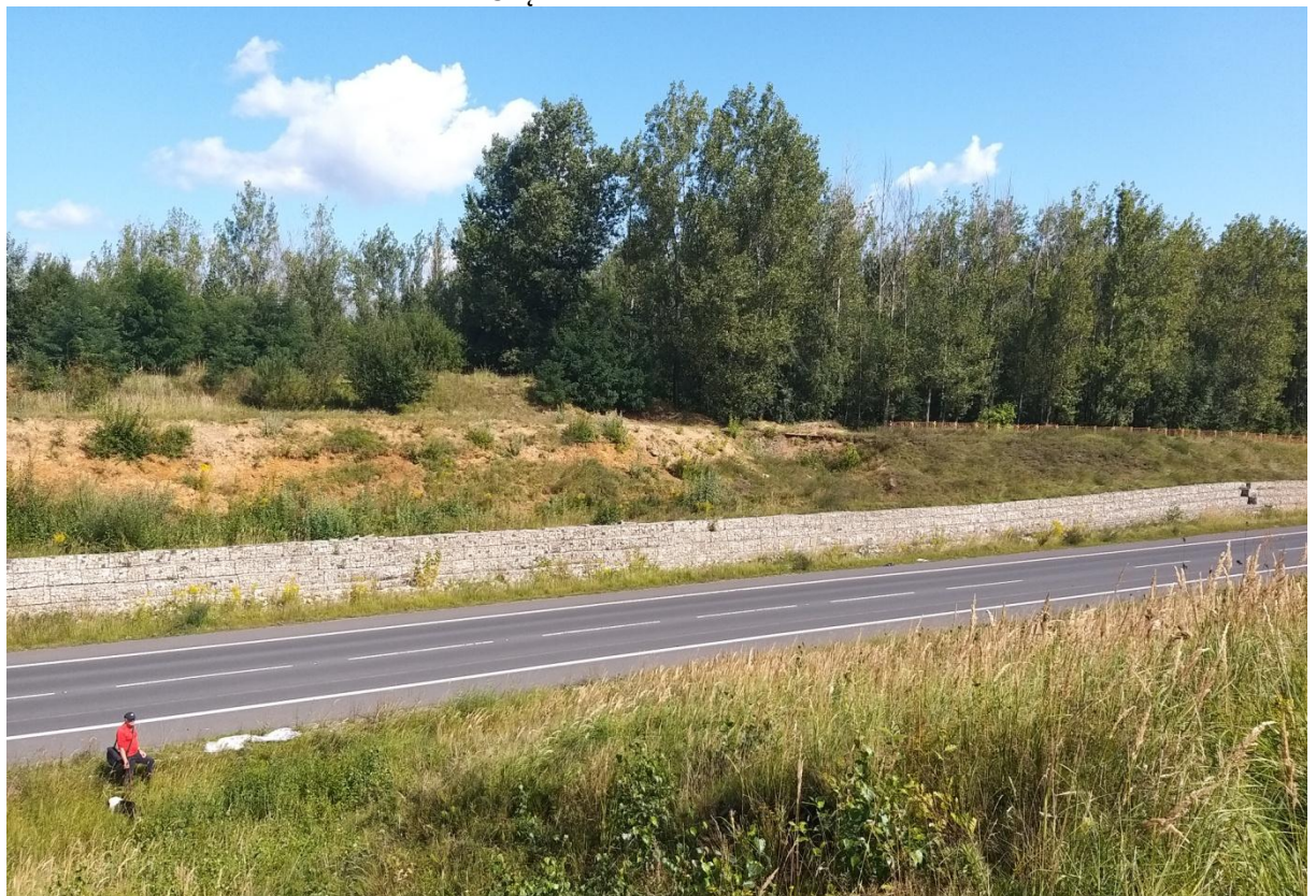
Część południowo osuwiska
