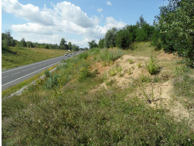
Erozja wierzchniej warstwy osuwiska na skarpie północno-wschodniej
