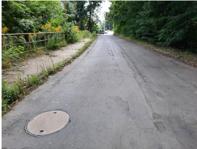
Uszkodzenia nawierzchni ulicy Pawickiej
