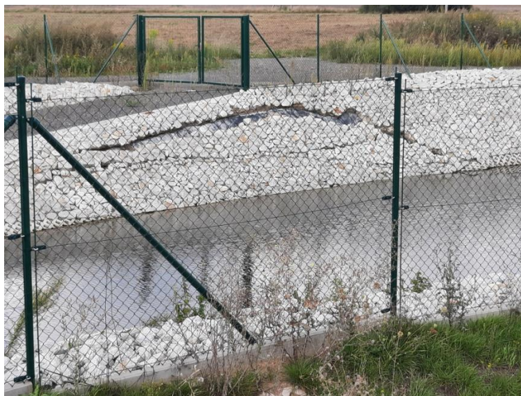
Uszkodzenia konstrukcji czaszy zbiornika
