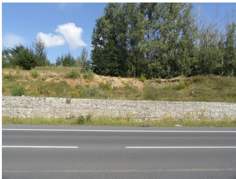
Osuwisko na skarpie północno-wschodniej wykopu ulicy Zachodniej
