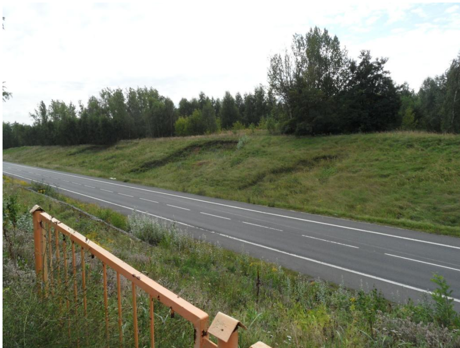
Osuwisko na skarpi południowo-zachodniej wykopu ulicy Zachodniej
