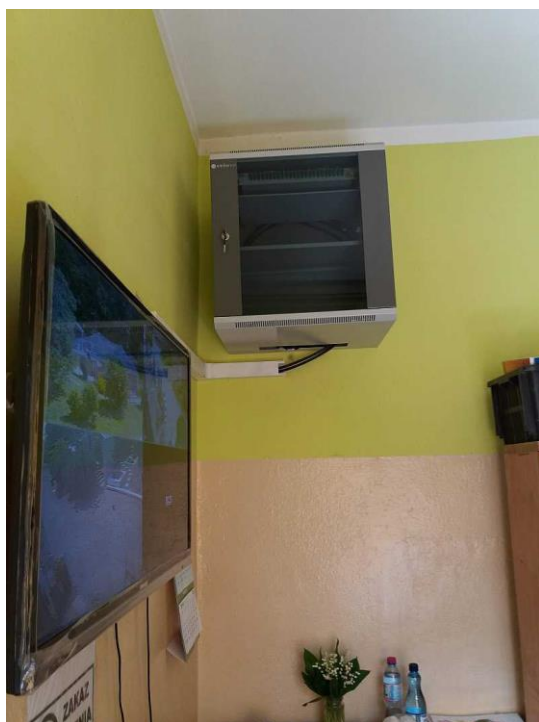
Istniejąca szafa teletechniczna sieci LEGMAN w budynku Palmiarni.
